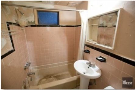
Logement insalubre dans Cartierville Photo : La Presse, 30 avril 2014
